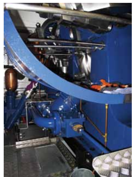
Gros tube cintré : amenée de vapeur d'échappement, robinet d'injection d'eau et tubulure vers pompe à air.
