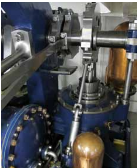
Pompe à air et réchauffeur en bas à gauche.
