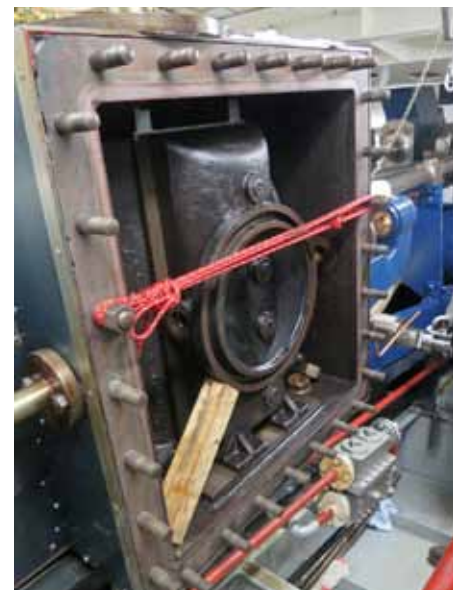
Tiroir du cylindre BP (basse pression).
